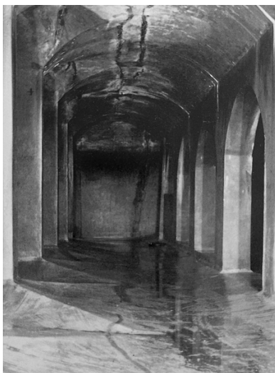
Abb. 14: Reservoir «Albishof» 1896, Aussenwände, Gewölbe und Leitwände in Beton (Quelle: Wasserversorgungsplan der Stadt Zürich, Textband, S. 65)
