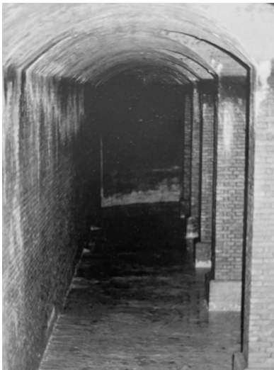
Abb. 13: Reservoir «Rämi» 1871, Aussenwände und Gewölbe in Backstein und Beton, Leitwände in Backstein (Quelle: Wasserversorgungsplan der Stadt Zürich, Textband, S. 65)
